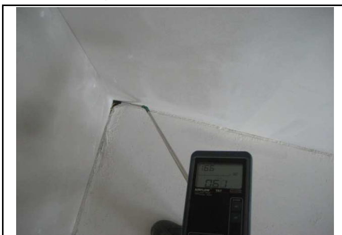
Neblīva konstrukciju mezgla vieta
