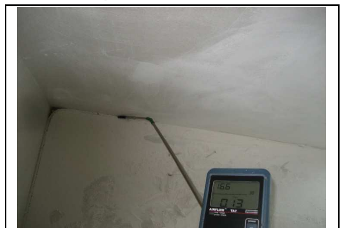
Neblīva konstrukciju mezgla vieta
