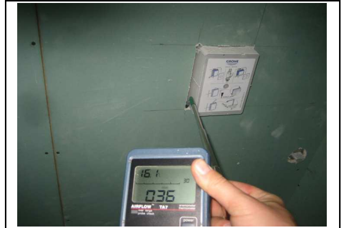
Gaiscaurlaidīga elektrokomunikāciju iebūves vieta
