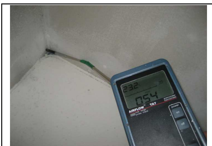
Neblīva konstrukciju mezgla vieta
