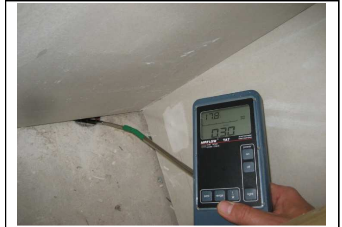
Neblīva konstrukciju mezgla vieta
