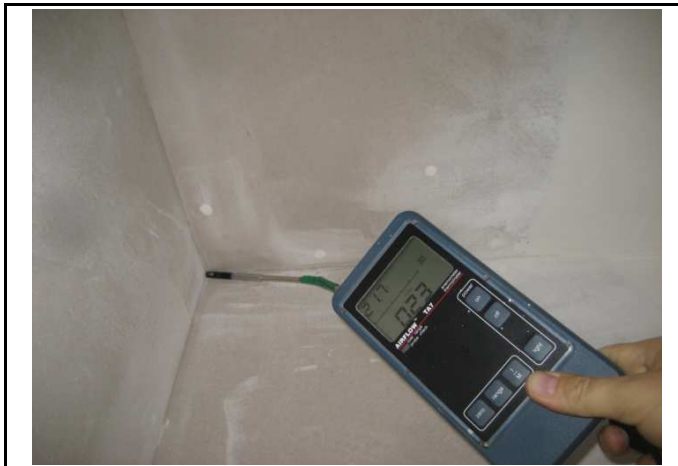
Neblīva konstrukciju mezgla vieta
