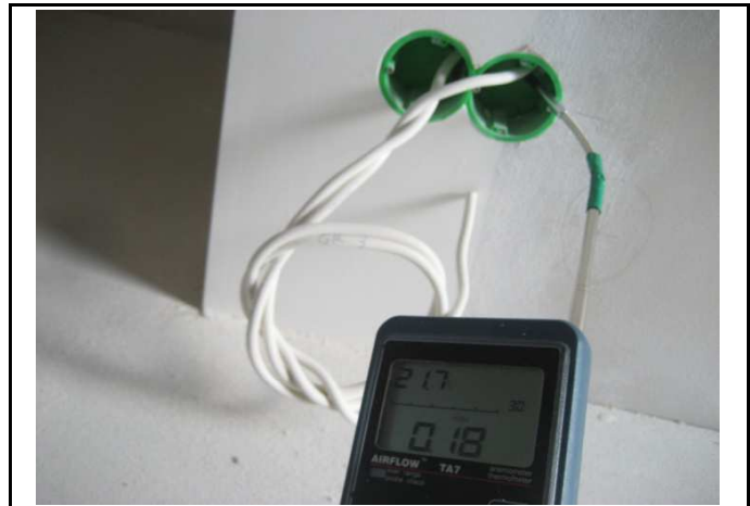
Gaiscaurlaidīga elektrokomunikāciju iebūves vieta
