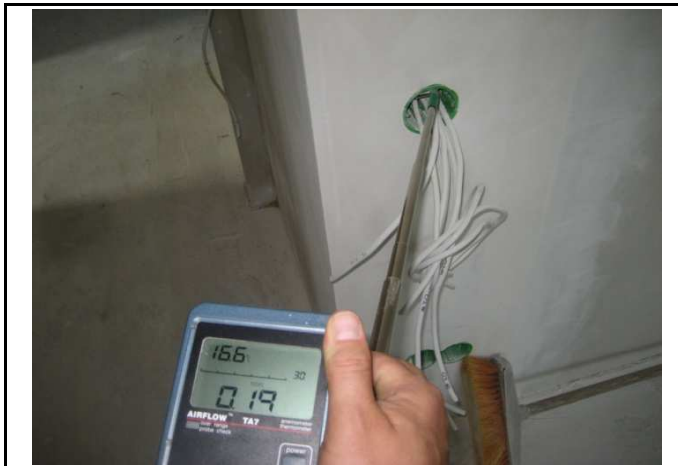
Gaiscaurlaidīga elektrokomunikāciju iebūves vieta
