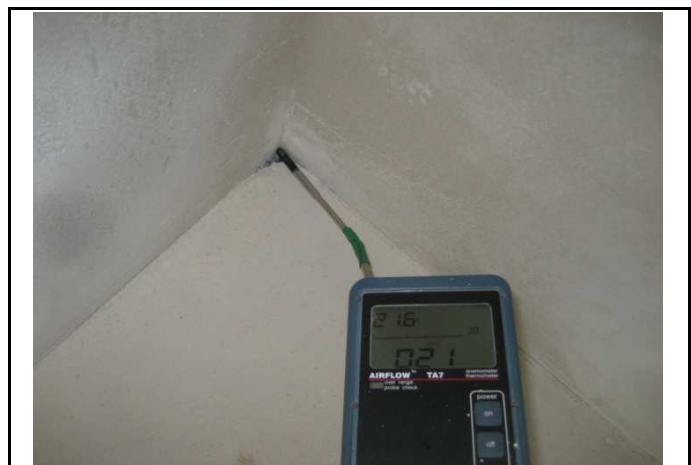
Neblīva konstrukciju mezgla vieta
