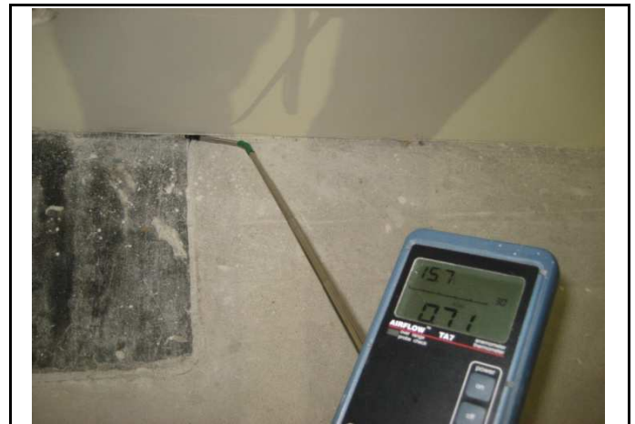
Neblīva konstrukciju mezgla vieta
